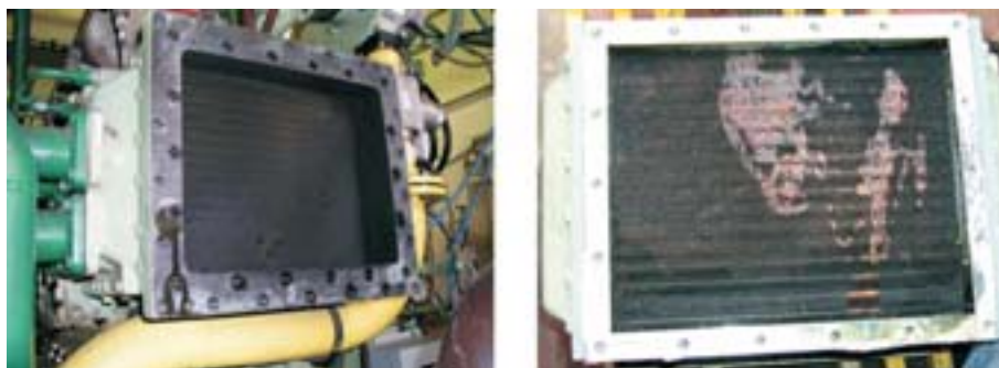
Rys. 4. Zanieczyszczona powierzchnia wlotowa chłodnicy mieszanki (rysunek lewy) oraz ślady uszkodzeń termicznych i mechanicznych strony wylotowej chłodnicy mieszanki (rysunek prawy)
